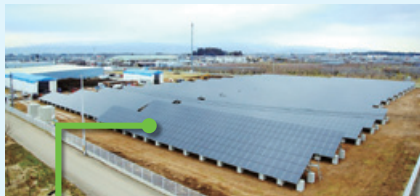
太陽光パネル
